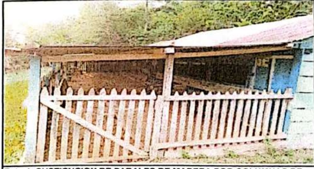
Foto 4: SUSTICION DE PARALES DE MADERA POR COLUMNAS DE CONCRETO.
